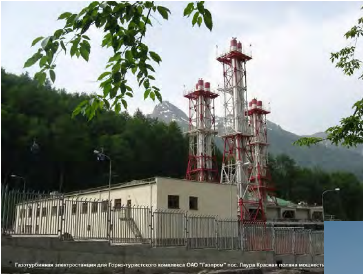
Газотурбинная электростанция для Горно-туристского комплекса ОАО "Газпром" пос. Лаура Красная поляна мощность
